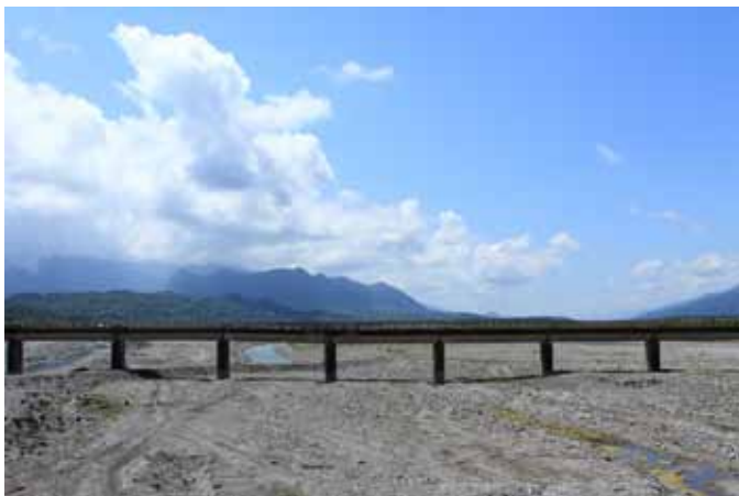
玉里舊鐵橋因斷層運動出現高低落差。
